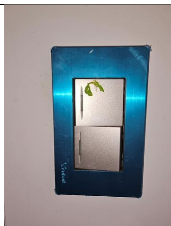
Fotografía No. 24. Interruptor doble marca Cubull instalado en Baño de Hombres.
