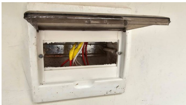
Fotografía No. 48. Tablero eléctrico de PVC que solo sirve como caja de pase al no contar con interruptores termomagnéticos ni diferenciales.
