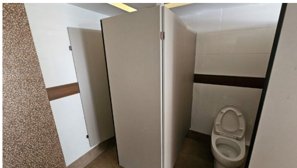
Fotografía No. 26. Separaciones de inodoros de melamina en Baño de Mujeres.
