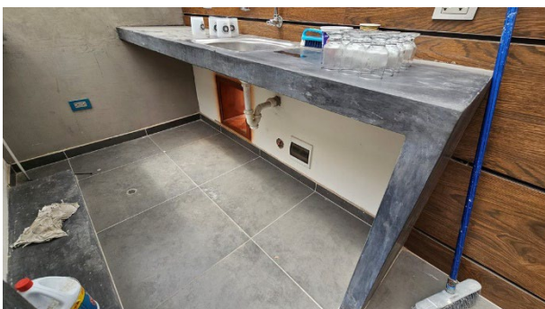
Fotografía No. 47. Vista de conexión de desagüe y conexión eléctrica debajo de mueble de concreto en cafetín.
