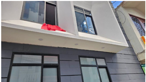
Fotografía No. 4. Luminarias LED Philips colocadas a los costados de la fachada.
