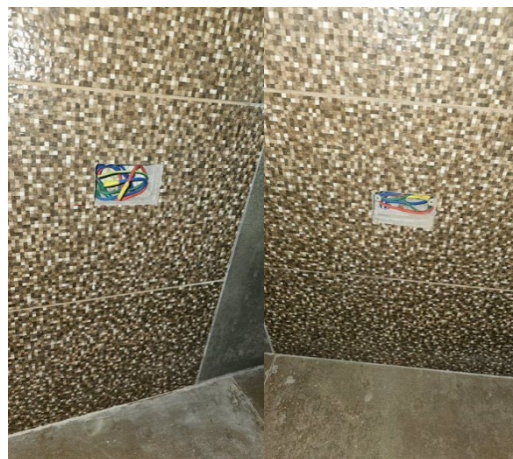
Fotografía No. 28. Cajas para salida eléctrica en muro donde falta colocar el tomacorriente (Baño de Mujeres)
