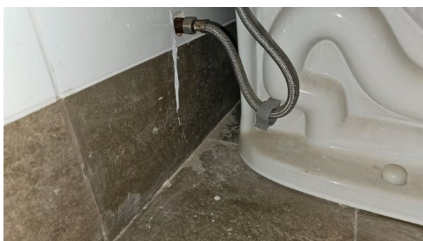
Fotografía No. 21. Tubo de abasto instalado en inodoros de los Baños de Hombres y Mujeres. Se aprecia restos de pintura en zócalo y piso.
