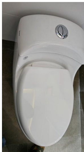
Fotografía No. 20. Inodoro One Piece marca Orange instalado en Baño de Hombres.
