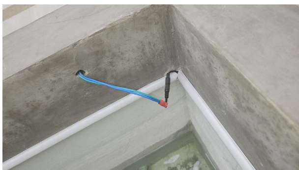
Fotografía No. 41. Conexión eléctrica sin canalizar dentro de fuente de agua. Representa un riesgo eléctrico.
