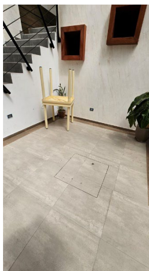
Fotografía No. 54. Tapa de cisterna a ras de piso, generando riesgo de contaminación por ingreso de aguas superficiales.
