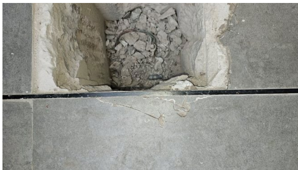
Fotografía No. 36. Vista del pozo de puesta a tierra. La entidad está adecuando la tapa para poder darle mantenimiento periódico.
