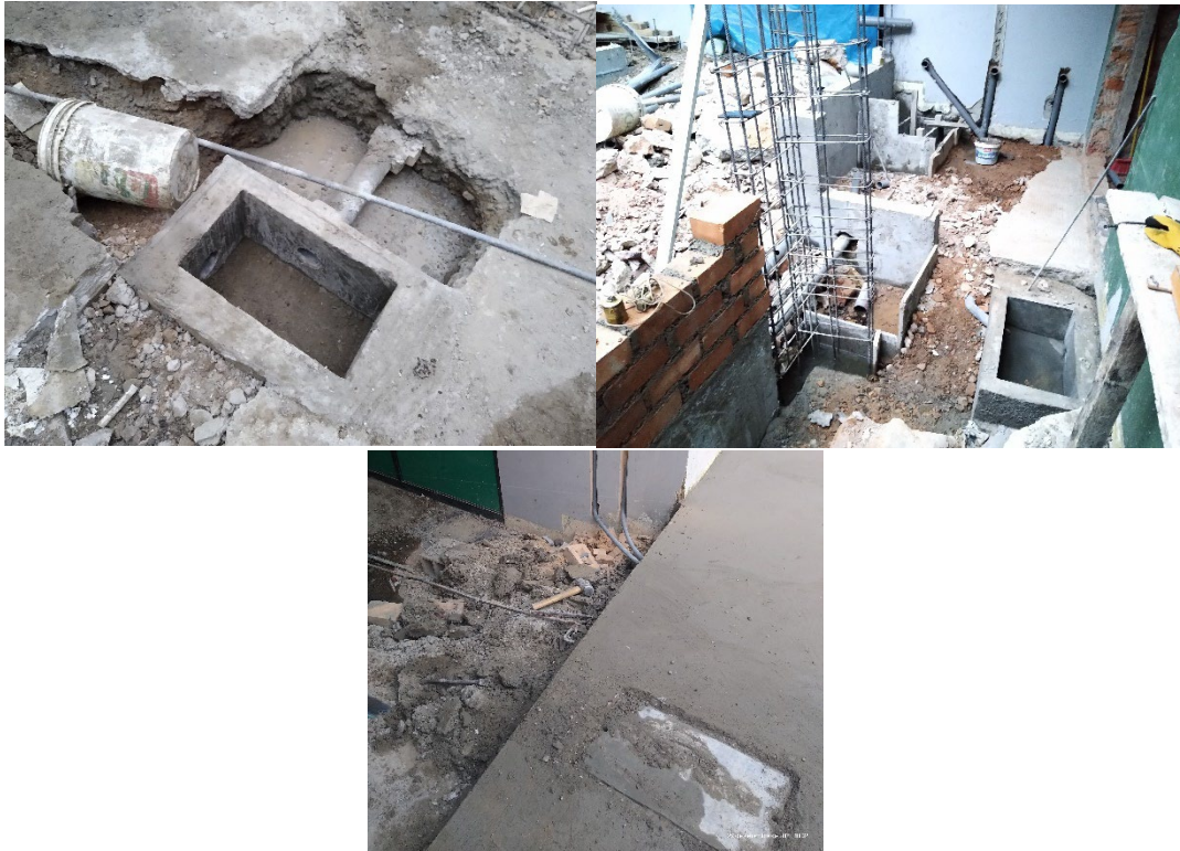
Fotografías que evidencian la existencia de las cajas de registro C2, C3 y C4
