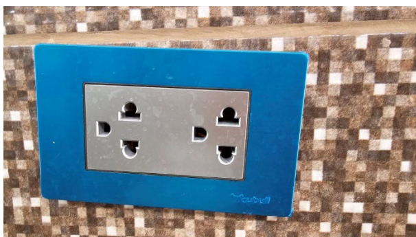
Fotografía No. 23. Tomacorriente doble marca Cubull con puesta a tierra instalado en Baño de Hombres.
