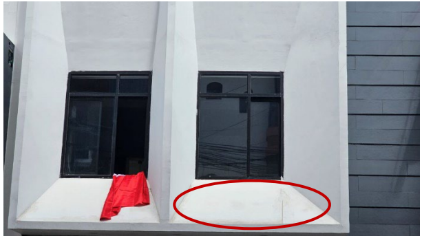
Fotografía No. 2. Señales de inicio de deterioro de acabados debido a precipitaciones pluviales en fachada.
