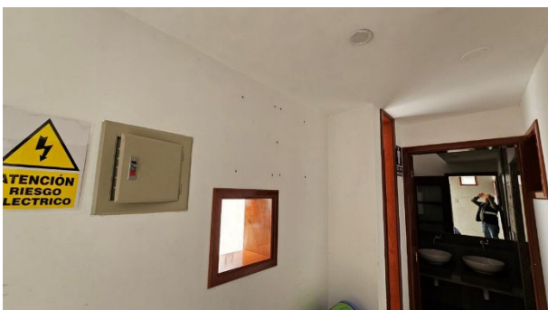
Fotografía No. 15. Otra vista del Hall de ingreso a servicios higiénicos donde se ve la ubicación del tablero eléctrico general.
