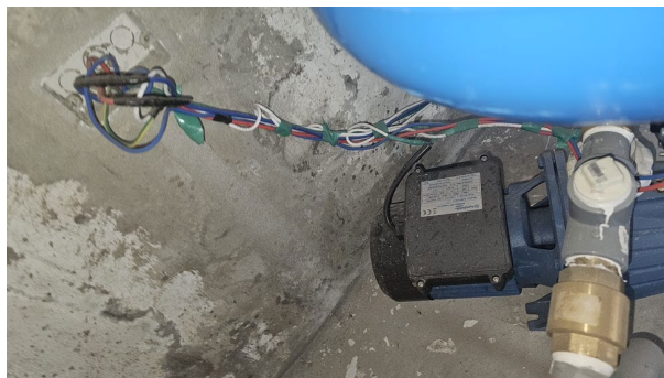
Fotografía No. 32. Mal estado de la conexión eléctrica de la bomba y tanque hidroneumático, los cables se encuentran expuestos, representando riesgo eléctrico.
