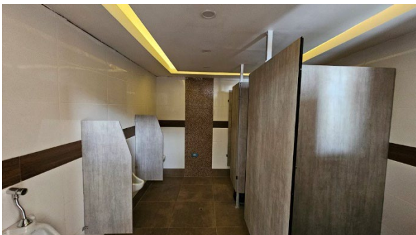
Fotografía No. 17. Vista de los urinarios marca Trébol con grifería de la misma marca y divisiones y puertas de melamina.
