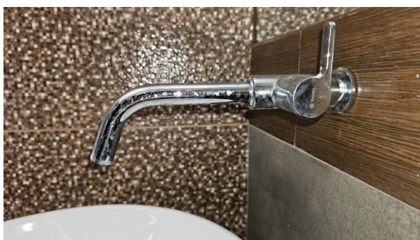
Fotografía No. 22. Grifería marca Trébol en lavatorios del Baño de Hombres y Mujeres .
