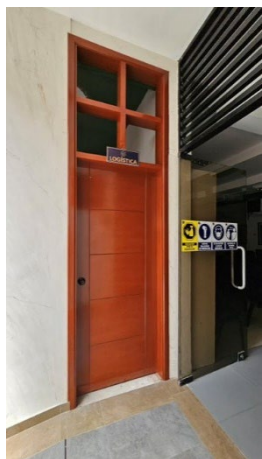
Fotografía No. 37. Puerta de ambiente denominado Logística ubicada en la parte inferior de escalera de acceso al Mezanine del Auditorio. Faltan vidrios en ventana.
