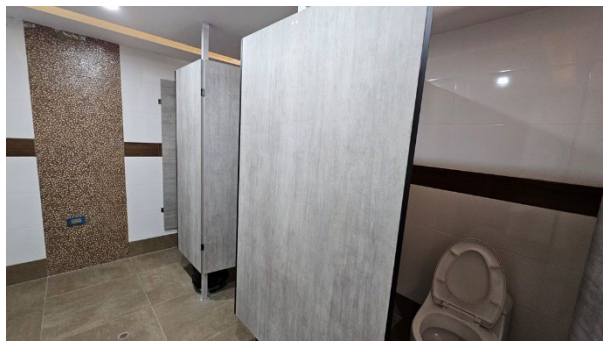
Fotografía No. 18: Inodoros tipo One Piece marca Orange instalados en baño de hombres.
